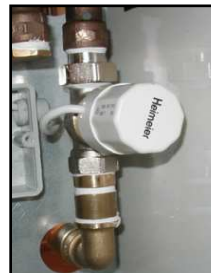
kuva sisäänrakennetusta termosähköisestä venttiilistä
